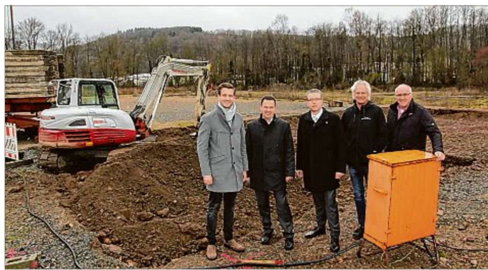
Die Baugrube am Johannes-Rau-Weg macht es deutlich: Auf dem ehemaligen Schulhof entsteht nun das Wohnquartier „Deichwald“. Darauf freuen sich (v. l.): Simon Flick (Firma Flick), Volker Schwarz und Ralf Stederoth (beide Volksbank), Architekt Werner Seelbach und Ingenieur Rüdiger Jung (Kotlan und Jung). Foto: Jan Schäfer
